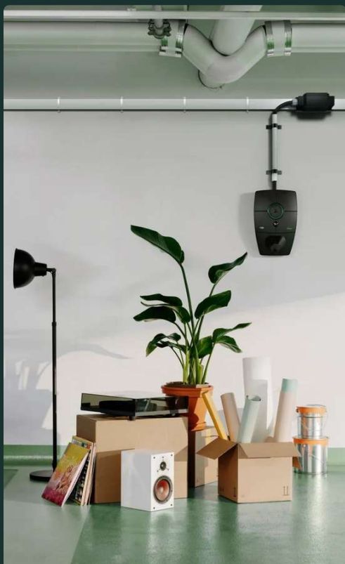
Parkeergarage met Zaptec Pro — officieel Zaptec-beeld.
