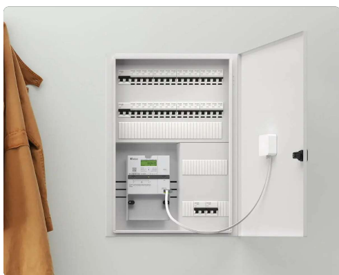
De loadbalancer wordt aangesloten op de P1-poort van uw slimme meter.
