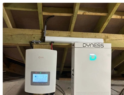
Op zolder, gekoppeld aan de Solis-omvormer
