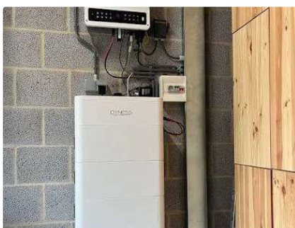
Tower Pro in de garage met Solis-omvormer
