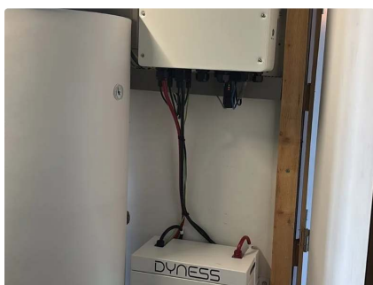
Naast de cv-ketel in de techniekruimte
