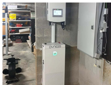
Ruim opgesteld in de kelder
