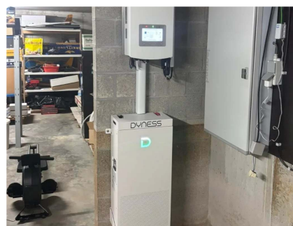
Ruim opgesteld in de kelder
