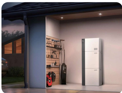
Buitenopstelling onder een overkapping.
